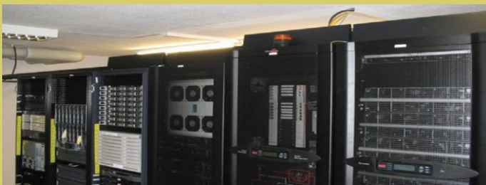
Các tủ máy trạm nhìn từ đằng trước của phòng. Ba tủ máy bên trái chứa các máy chủ HPC. Các tủ máy phía bên phải của các máy chủ HPC là các máy chủ trung gian, máy chủ dự phòng, máy chủ lưu trữ dữ liệu, máy chủ tệp tin và hệ thống nguồn cấp điện hoạt động liên tục.
